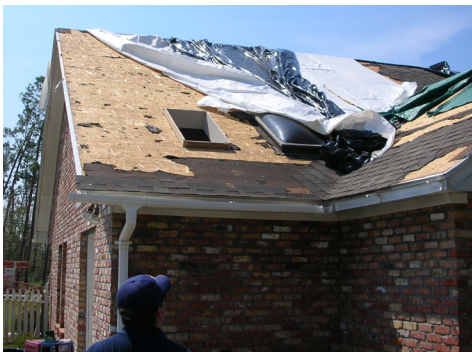
Les vents violents sont une des principales causes des dommages causés aux toitures.
