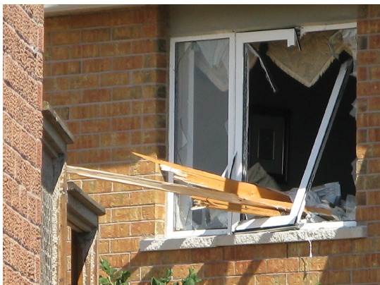
Les débris propulsés par des vents violents peuvent facilement pénétrer par des fenêtres non protégées.
