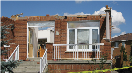
Le soulèvement de la toiture est une cause fréquente des dommages attribuables aux vents violents et aux tornades.
