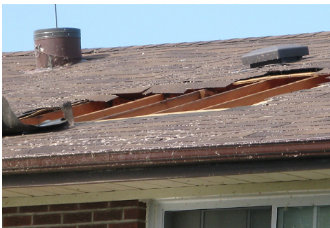
Le support de couverture doit être solidement fixé pour éviter que les grands vents n'endommagent la toiture.
