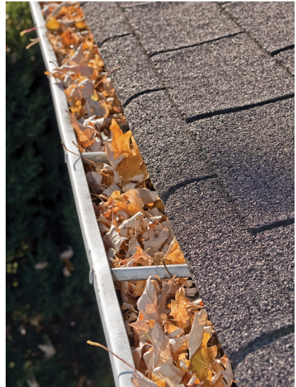
Des gouttières bloquées peuvent nuire au drainage de la couverture et provoquer la formation de barrières de glace.
