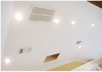
Les plafonniers à éclairage incandescent peuvent souvent dégager assez de chaleur dans le grenier pour faire fondre la neige sur le toit.
